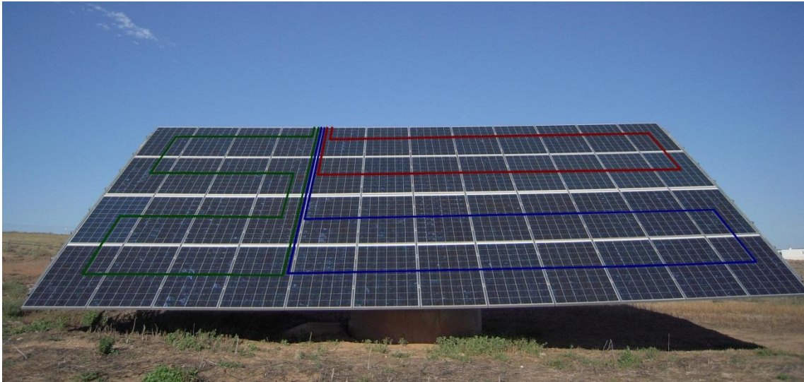
Fotografía 2. FOTOGRAFIA DE SEGUIDOR, CON SUS 48 MODULOS DISTRIBUIDOS EN 4 FILAS DE 12 MODULOS CADA UNA.
